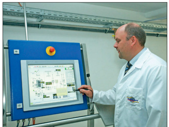
Abb. 7: Steuerung mittels Touchscreen
